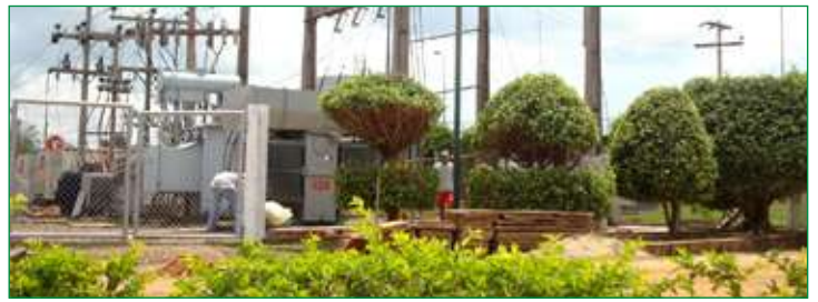
Planta generadora de electricidad Moxos, Ciudad de Cobija - Pando
