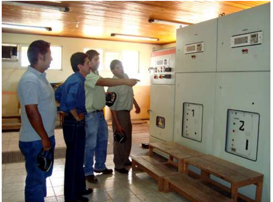
La planta ejecutiva de la AE, visita planta generadora Moxos en Cobija - Pando
